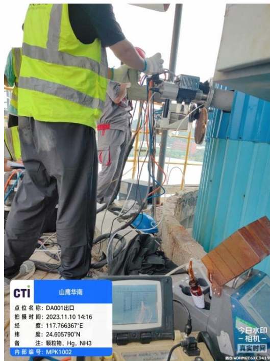
DA001 (1#FGD)出口
